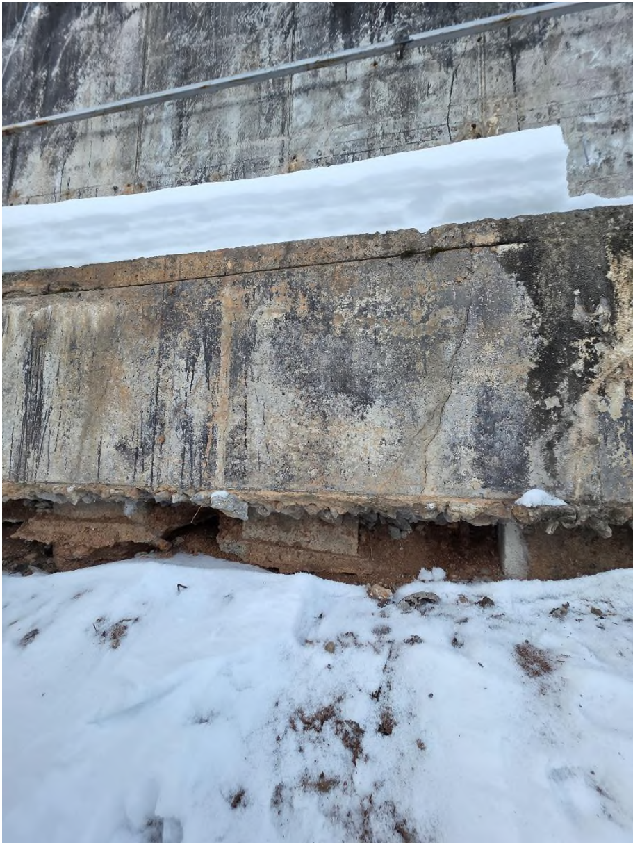
Фото 19. Оголение свайного фундамента центральной части подпорной стены в результате вымывания и сползания грунта.
