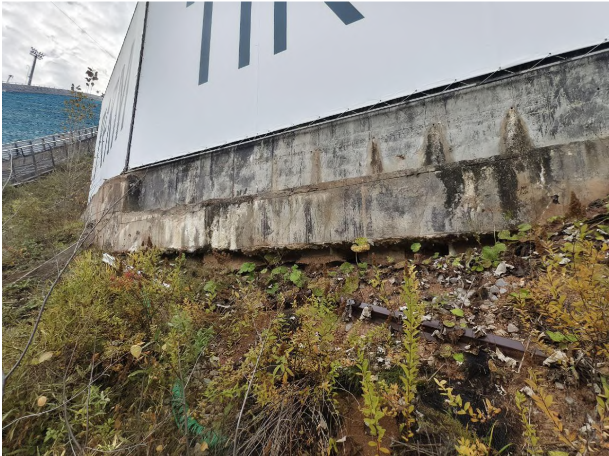
Фото 23. Оголение свайного фундамента центральной части подпорной стены в результате вымывания и сползания грунта. Фотография предоставлена заказчиком.
