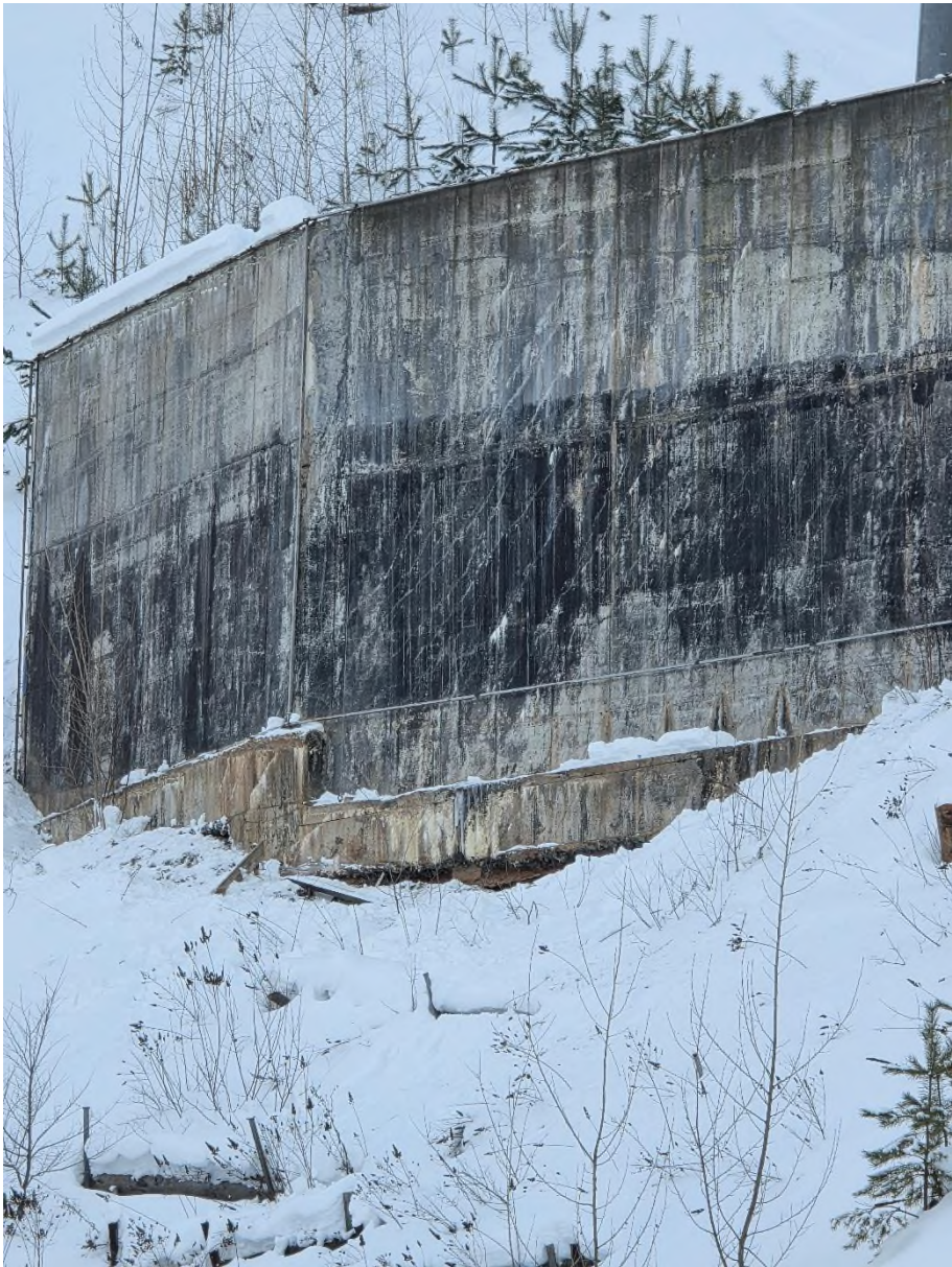
Фото 2. Подпорная стена в осях 4-3, 3-2. Многочисленные наклонные трещины в центральной части стены, в осях 3-2.
