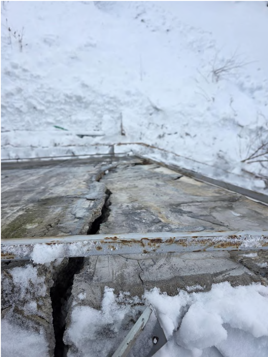
Фото 12. Вертикальная сквозная трещина в подпорной стене. Вид сверху.
