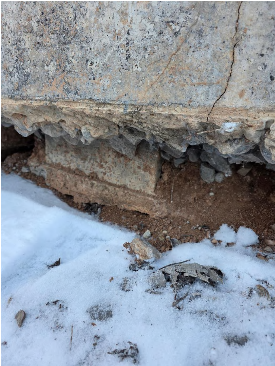
Фото 21. Оголение свайного фундамента центральной части подпорной стены в результате вымывания и сползания грунта.
