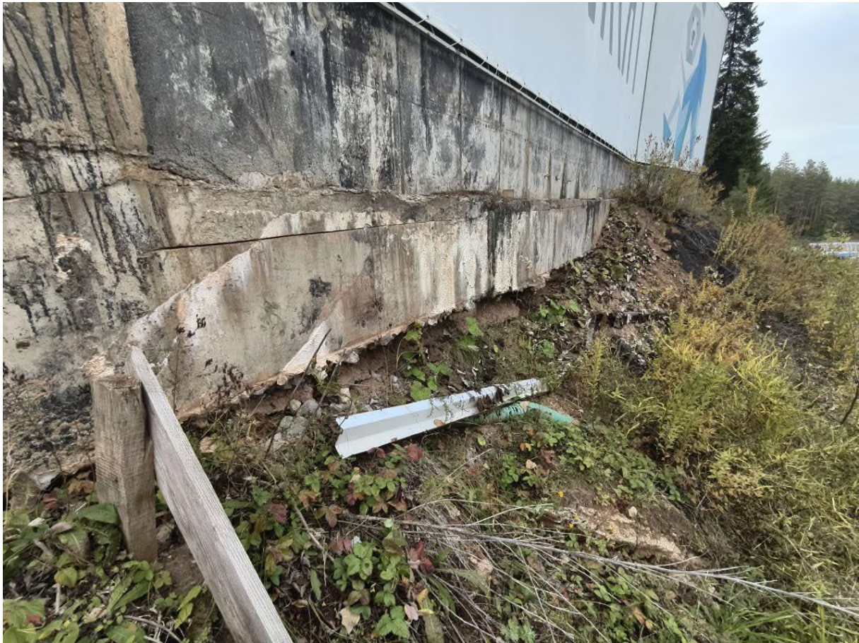
Фото 24. Оголение свайного фундамента центральной части подпорной стены в результате вымывания и сползания грунта. Фотография предоставлена заказчиком.
