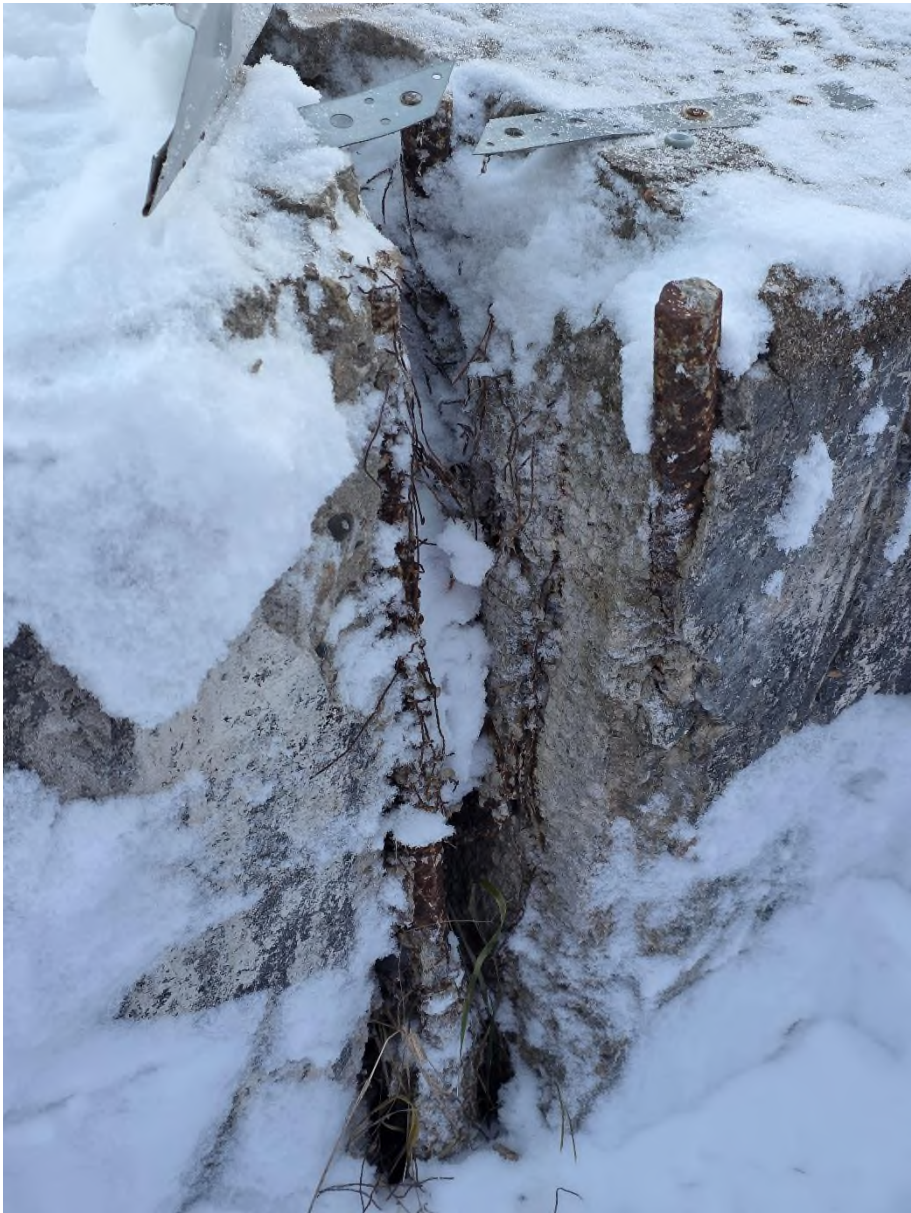
Фото 11. Вертикальная сквозная трещина в верхней части подпорной стены.
