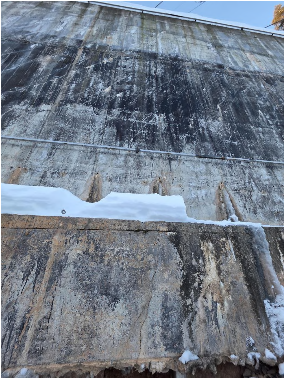
Фото 10. Фрагмент подпорной стены в осях 2-3. Многочисленные наклонные волосяные трещины. Наклонные трещины в ростверке.
