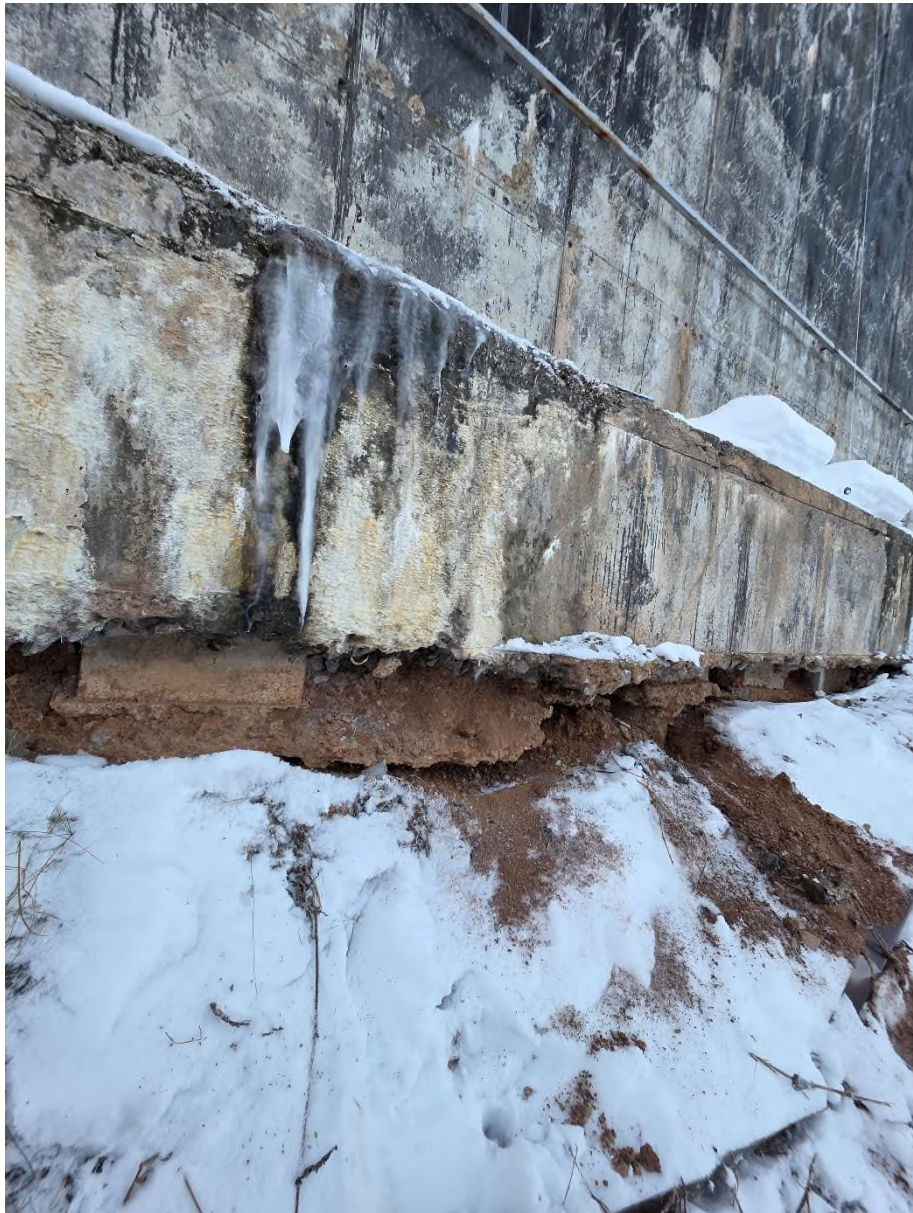
Фото 22. Оголение свайного фундамента центральной части подпорной стены в результате вымывания и сползания грунта. Выход грунтовых вод с последующим обледенением из монтажных отверстий и трещин в подпорной стене в осях 2-3.
