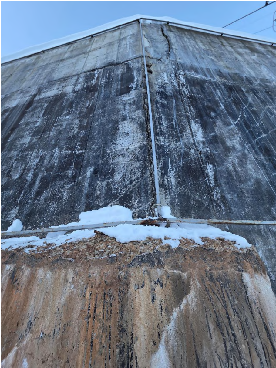
Фото 9. Сквозная вертикальная трещина в подпорной стене по оси 3.
