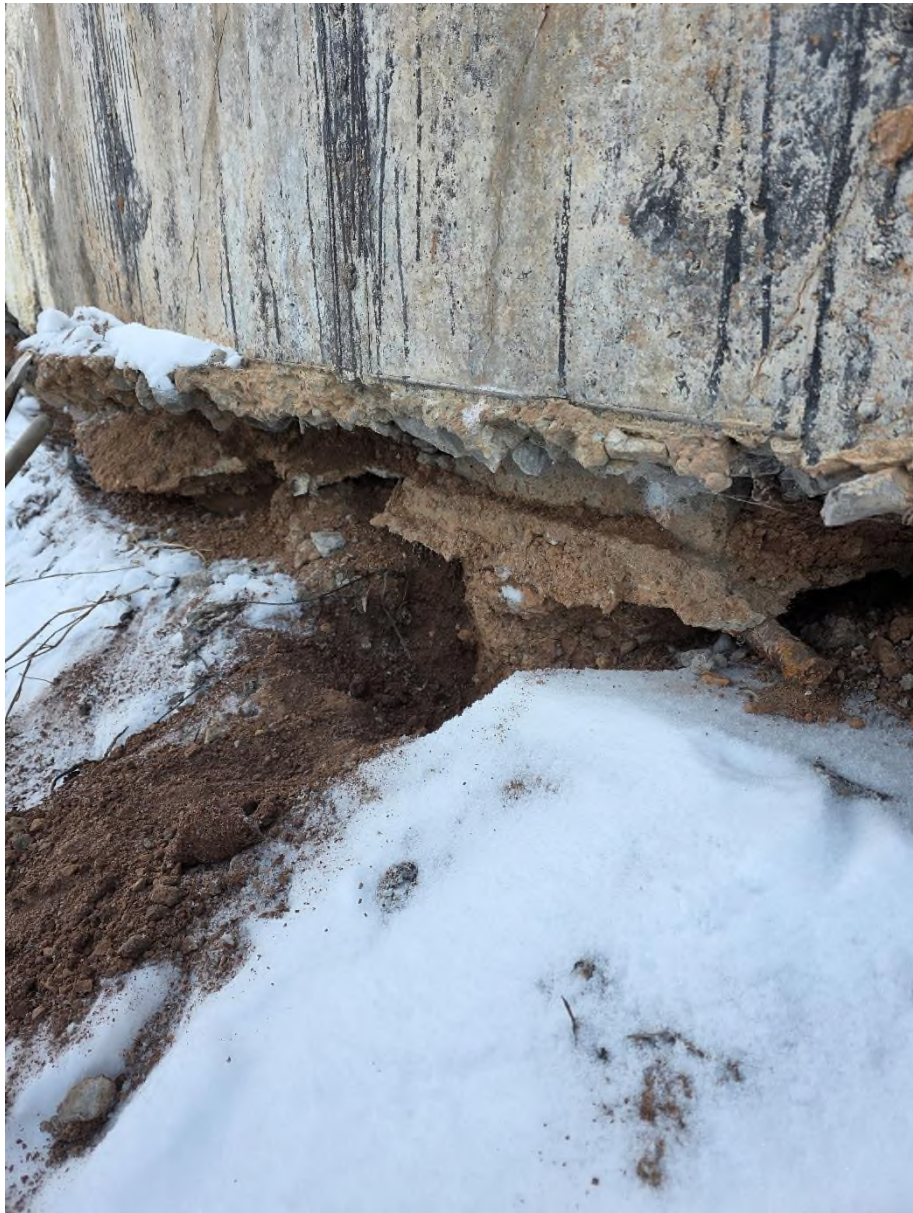
Фото 20. Оголение свайного фундамента центральной части подпорной стены в результате вымывания и сползания грунта.
