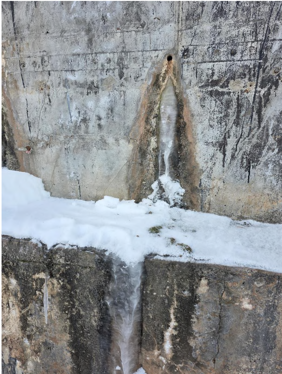
Фото 18. Выход грунтовых вод с последующим обледенением из монтажных отверстий и трещин в подпорной стене в осях 2-3.
