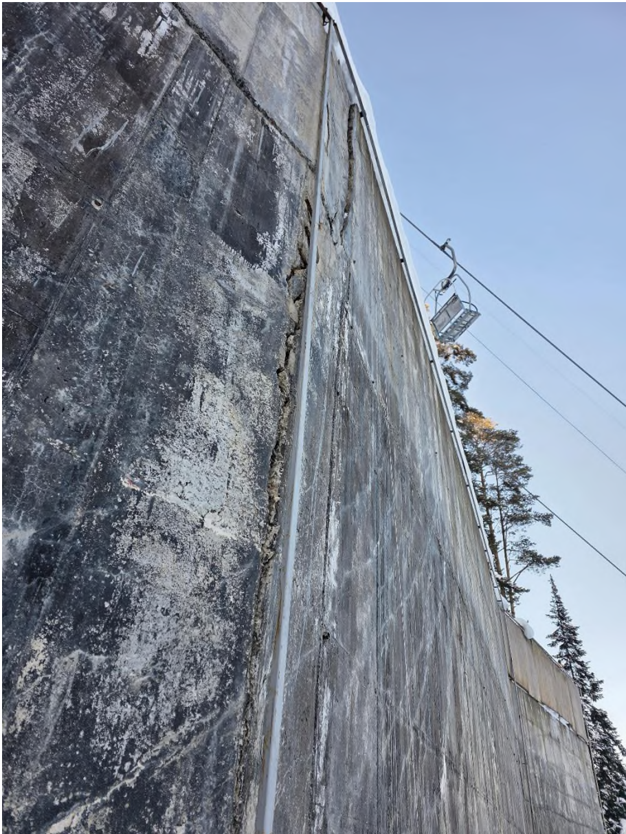
Фото 6. Вертикальная сквозная трещина в подпорной стене по оси 3.
