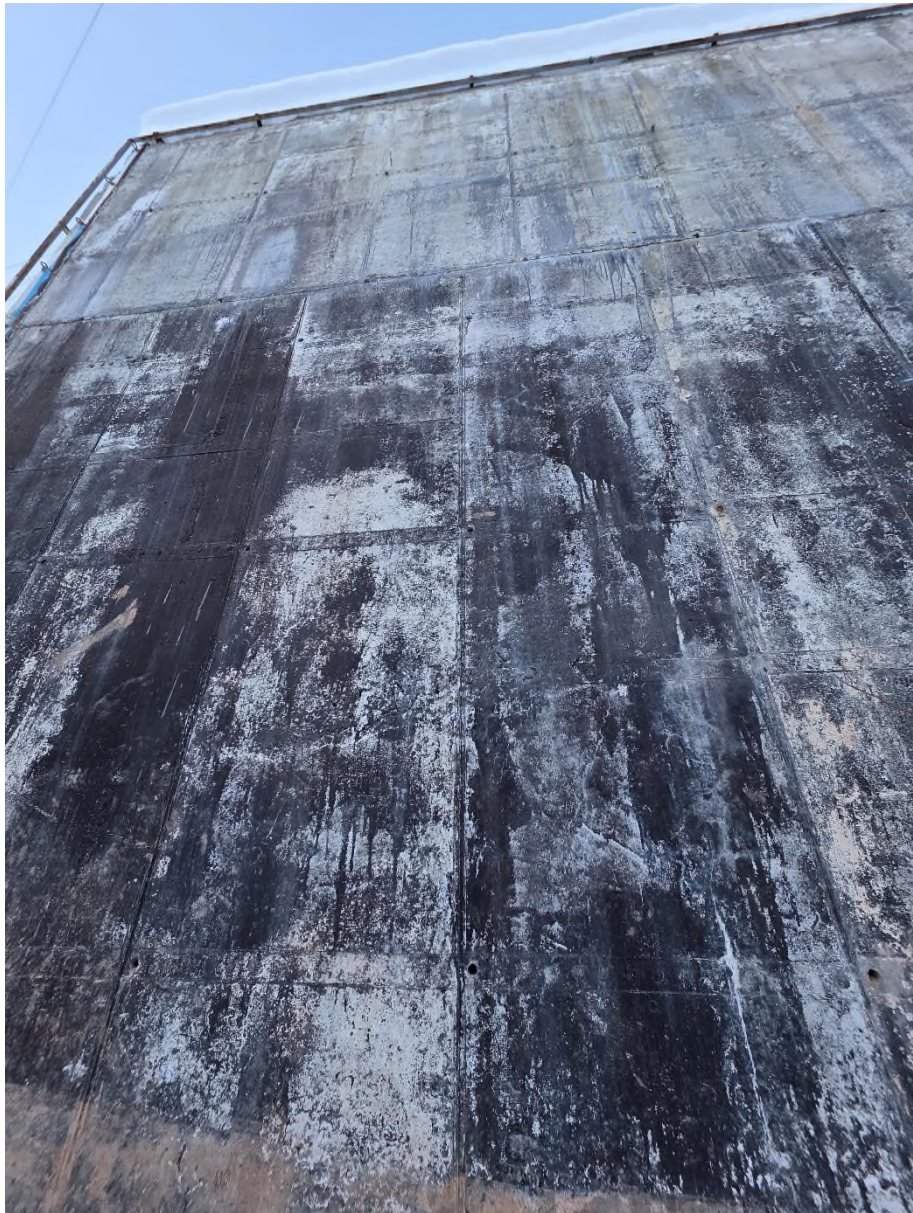
Фото 7. Фрагмент подпорной стены в осях 2-3. Многочисленные наклонные волосняные трещины.
