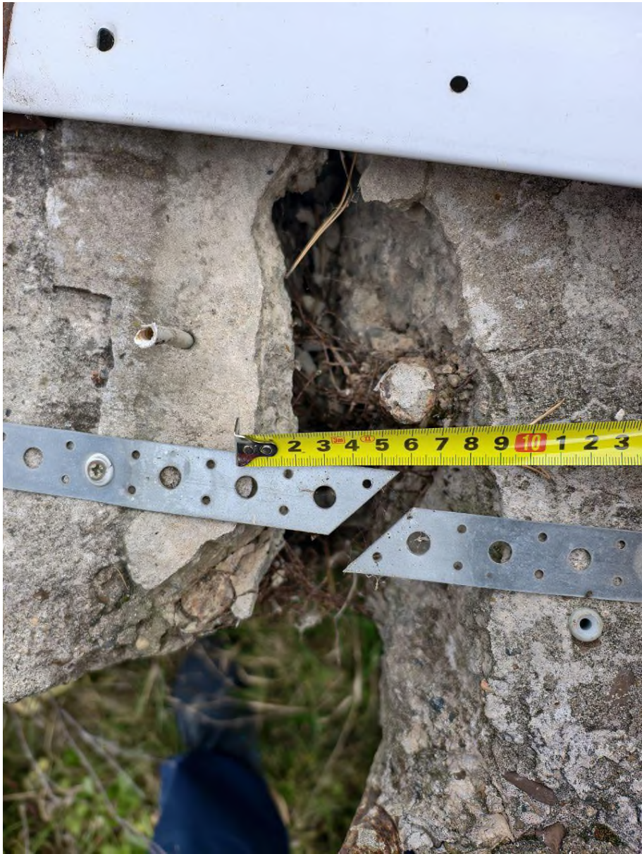
Фото 15. Вертикальная трещина в верхней части подпорной стены по оси 3, максимальной шириной раскрытия до 8 см. Фотография предоставлена заказчиком.
