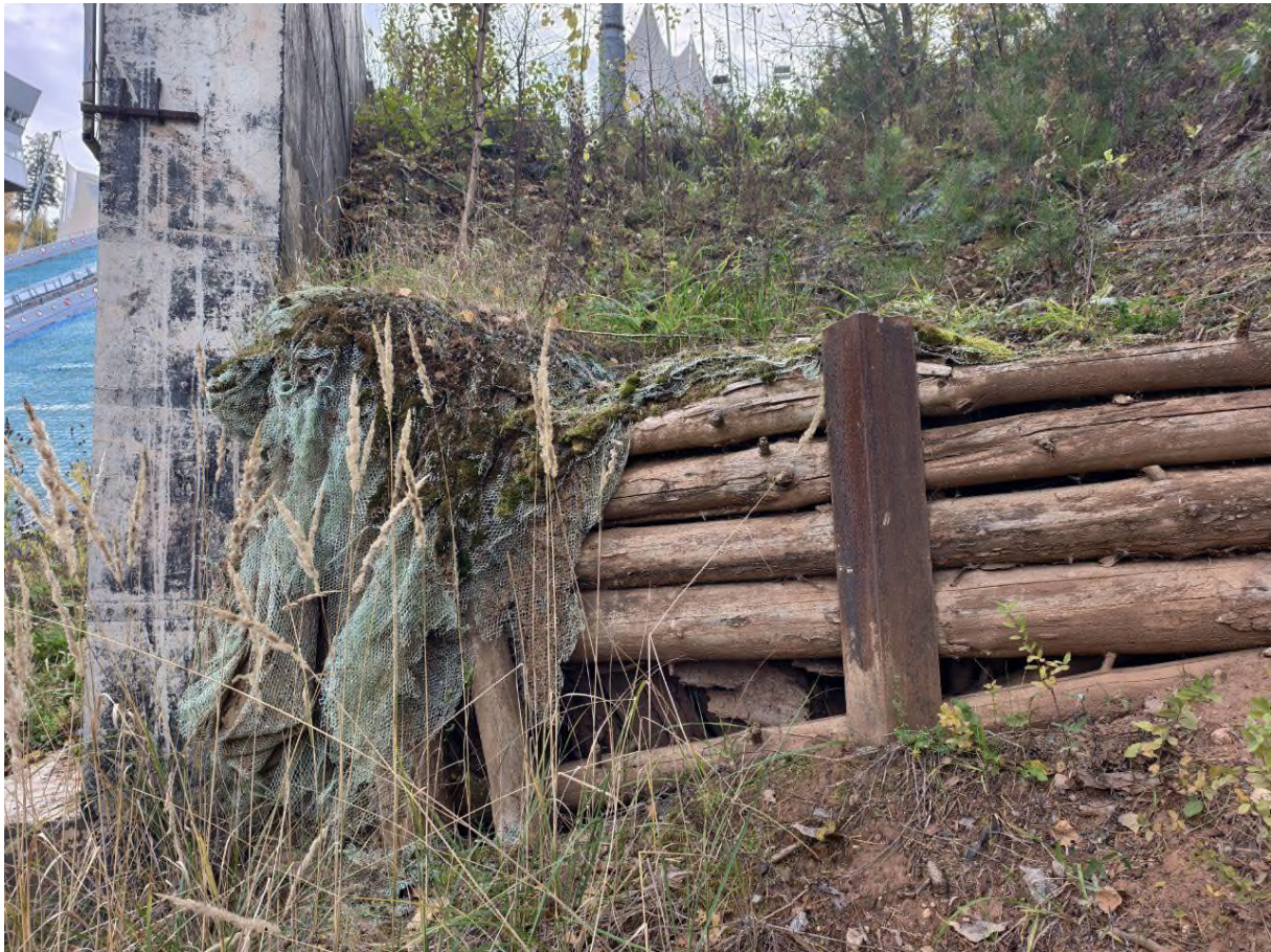
Фото 25. Самодельные грунтозадерживающие конструкции рядом с подпорной стеной по оси 1. Фотография предоставлена заказчиком.
