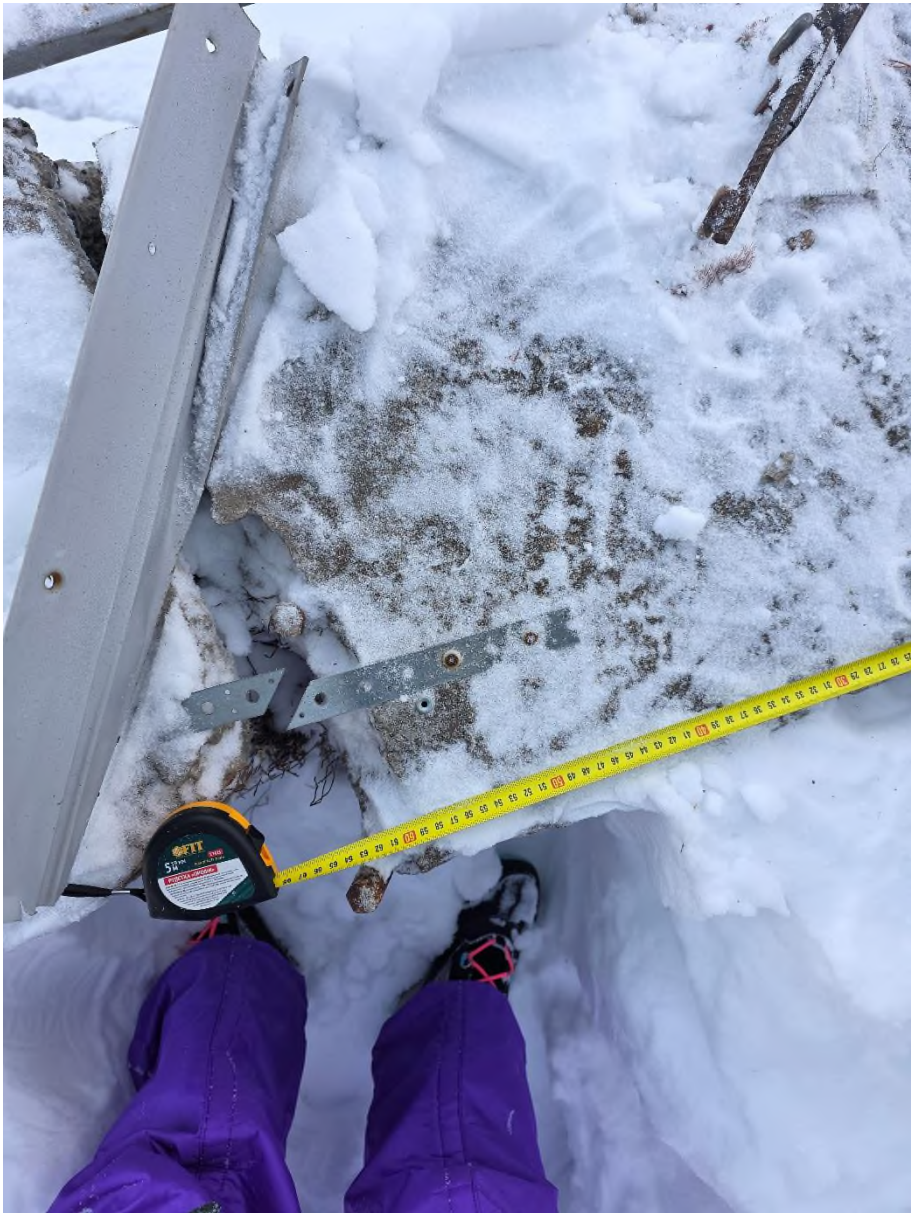
Фото 13. Вертикальная сквозная трещина в верхней части подпорной стены, максимальной шириной раскрытия до 8 см.
